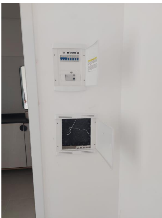
FOTO 06 – Vista quadros elétricos
