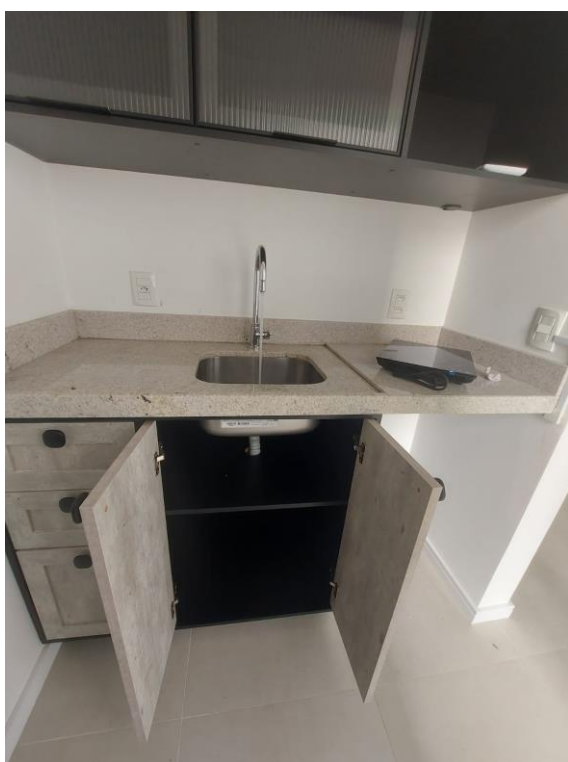
FOTO 04 – Vista Copo – Instalações Hidrossanitárias
